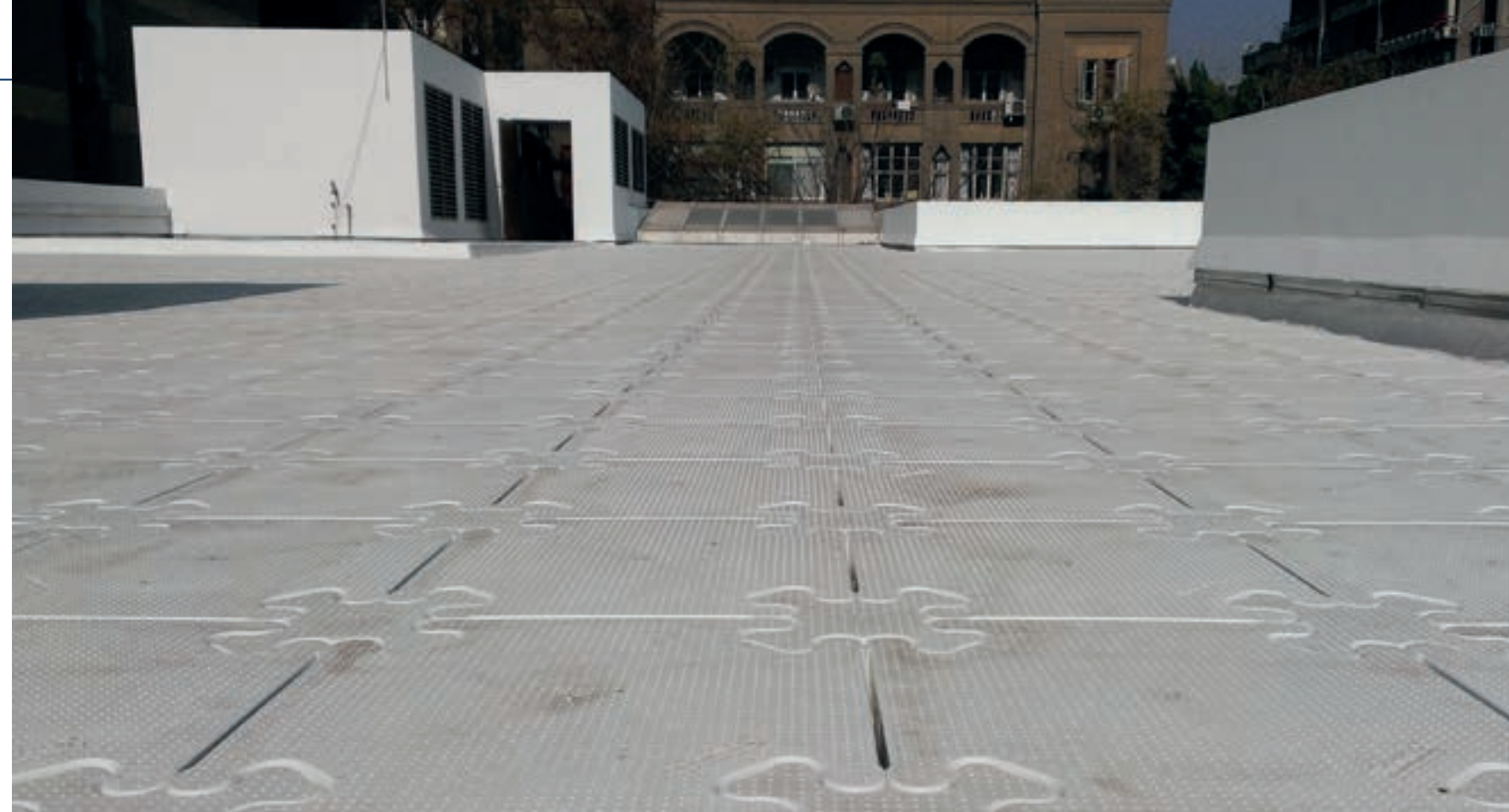
Op het dak van de Nederlandse ambassade in Caïro liggen Roofclix-tegels.
